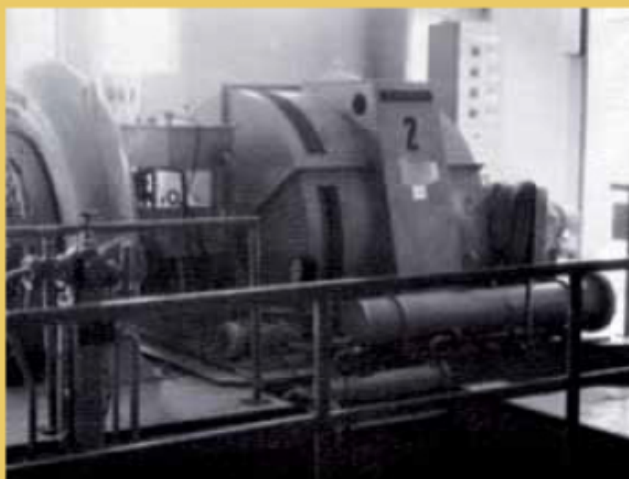
กังหันน้ำและเครื่องกำเนิดไฟฟ้า ในโรงไฟฟ้าพลังน้ำแม่กิมหลวง
