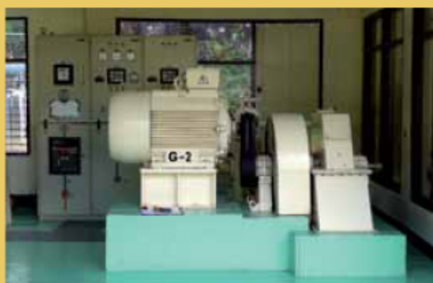
กังหันน้ำและเครื่องกำเนิดไฟฟ้า ในโรงไฟฟ้าพลังน้ำบ่อแก้ว
