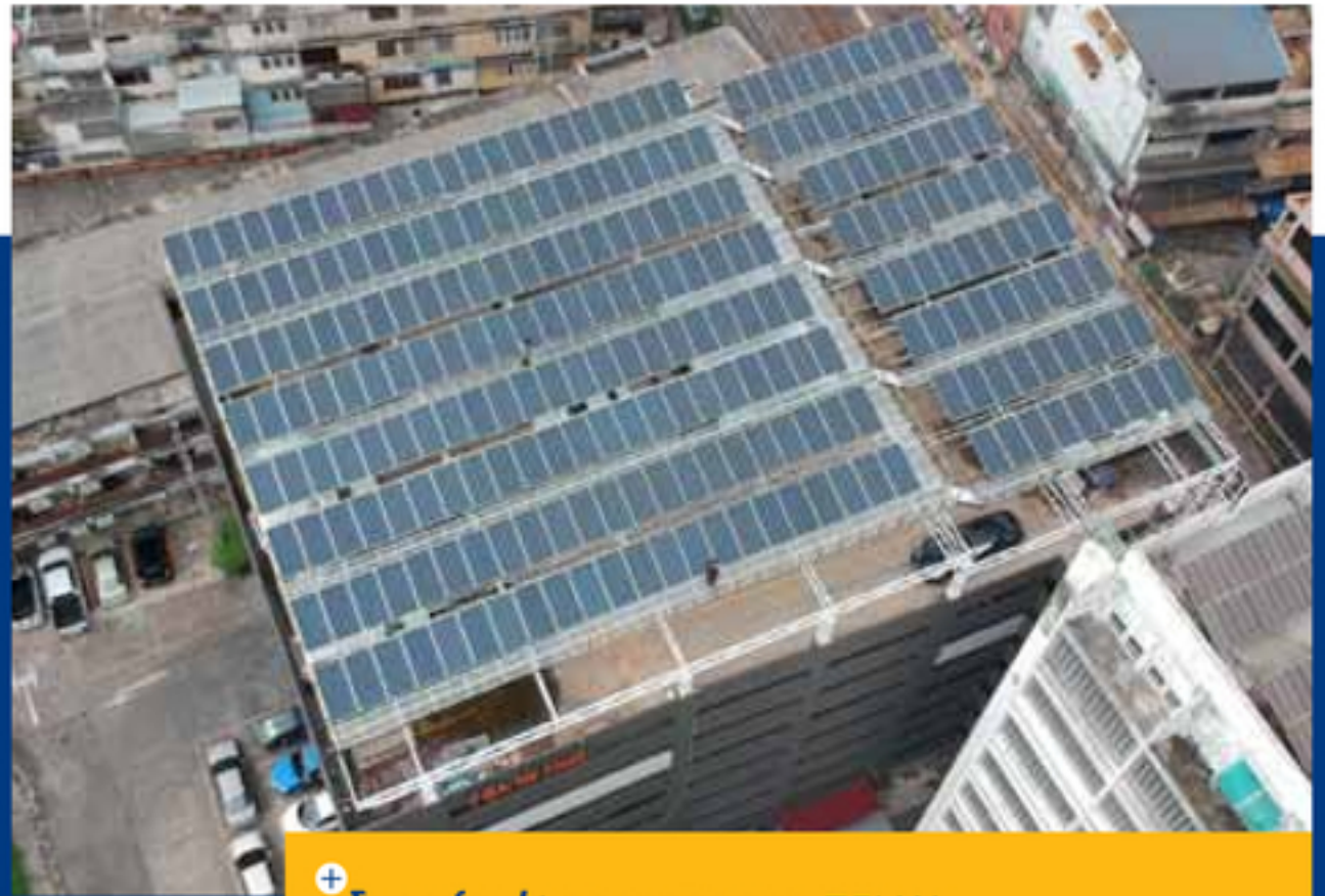
+ โซลาร์รูฟ | อาคารจอดรถ 75kW กรมพัฒนาพลังงานทดแทนและอนุรักษ์พลังงาน (พพ.)
