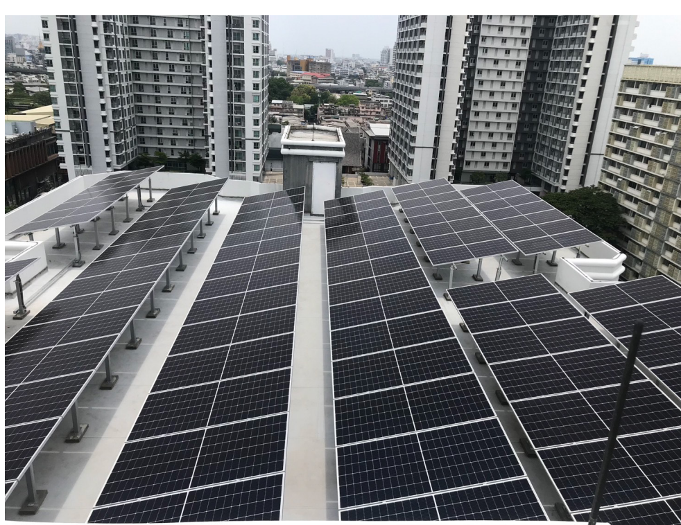
การติดตั้งโซลาร์เซลล์บนอาคารที่จุฬาลงกรณ์มหาวิทยาลัย
